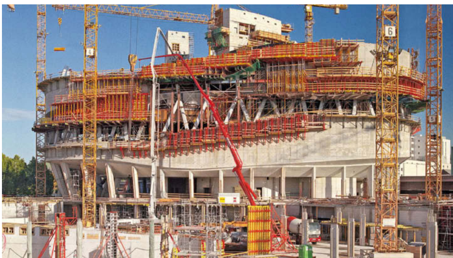
Mercedes-Benz Museum, Stuttgart: Im 3D-Verfahren wurde vorab ein Rastermodell mit klar definierten Ankerpositionen und Schalungsplattenstößen entwickelt.
